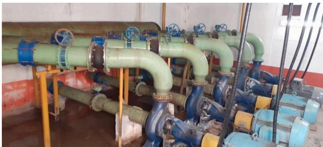
Sala de Bombeo Cisterna Pereyra
